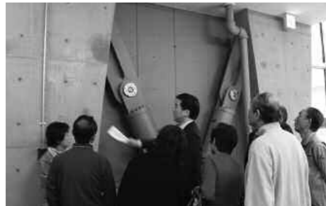
中央のV字が知的制振システム「TASMO」のオイルダンパー
